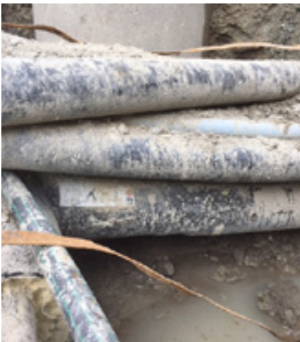
Fehlende Hinterfüllung von Werkleitungen
