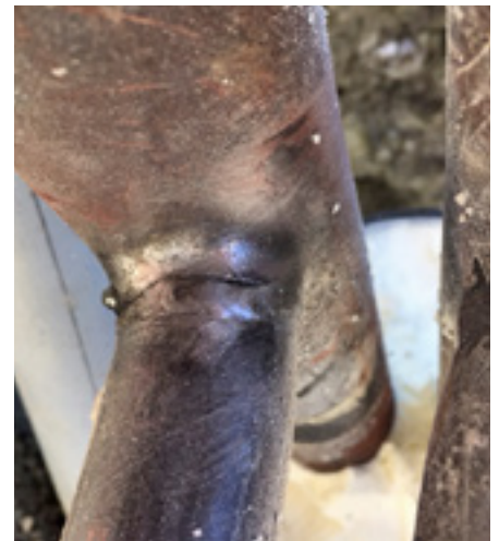
Undichte Schweißnaht im Abzweiger
