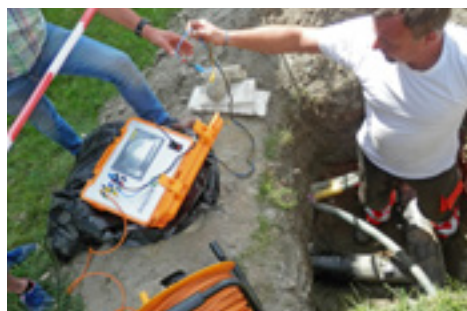
Einsatz Messeinrichtung für Fehlersuche
